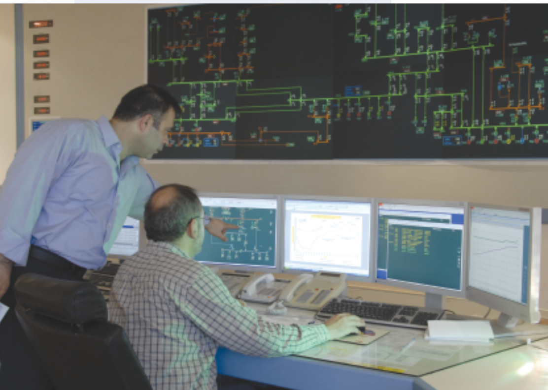
Το Εθνικό Κέντρο Ελέγχου Ενέργειας του Διαχειριστή Συστήματος Μεταφοράς
