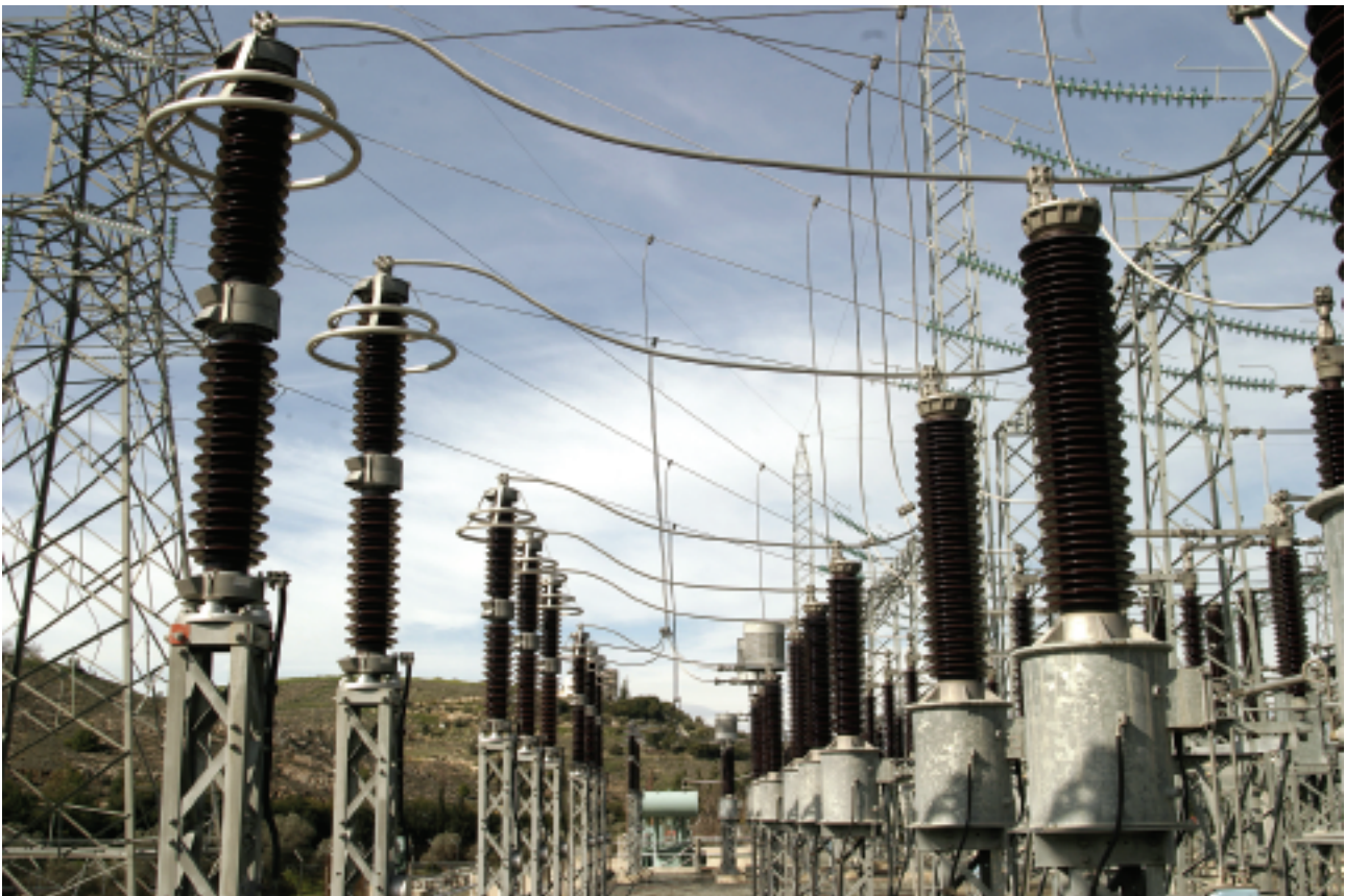
Εξοπλισμός Υποσταθμού Μεταφοράς 132kV Υπαίθριου Τύπου
