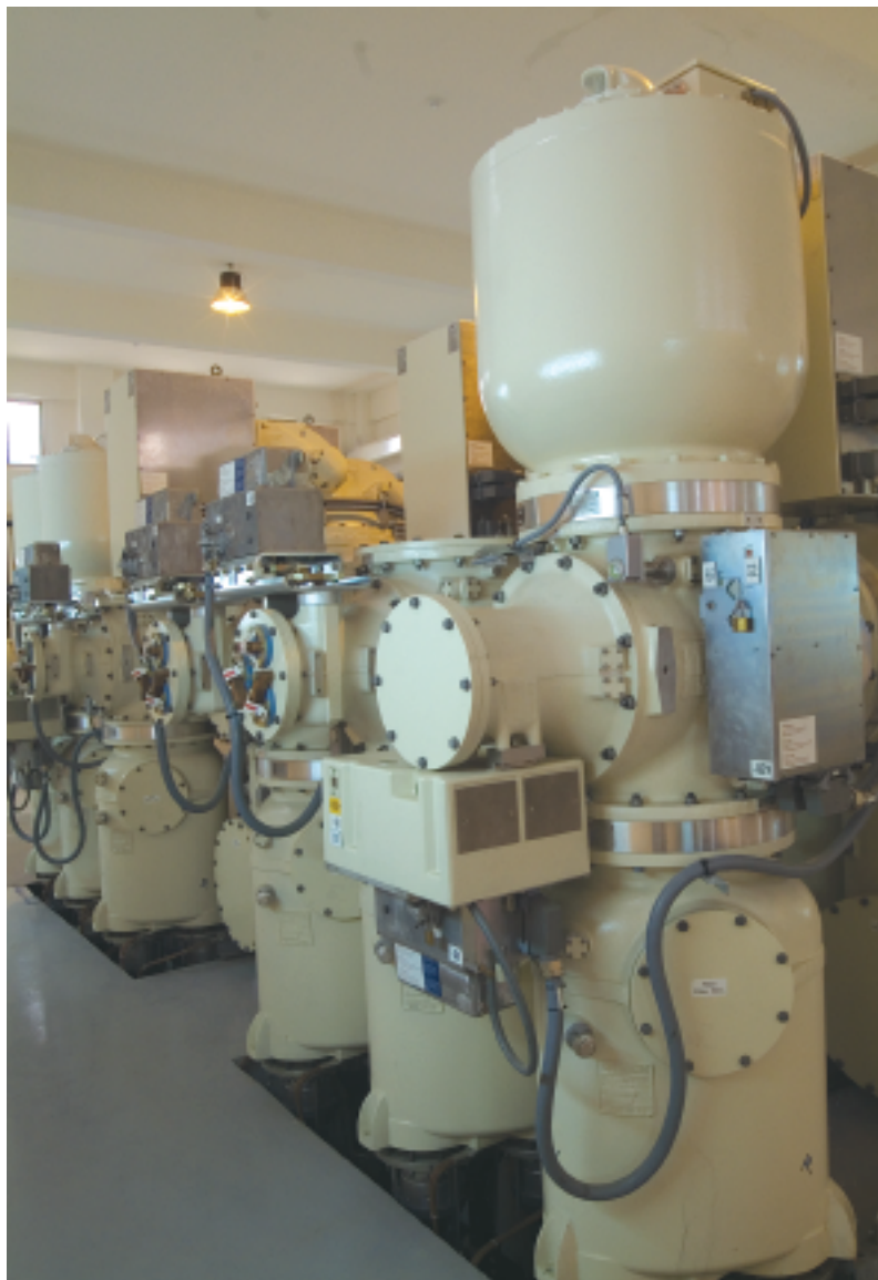
Εξοπλισμός Υποσταθμού Μεταφοράς 132kV Κλειστού Τύπου
